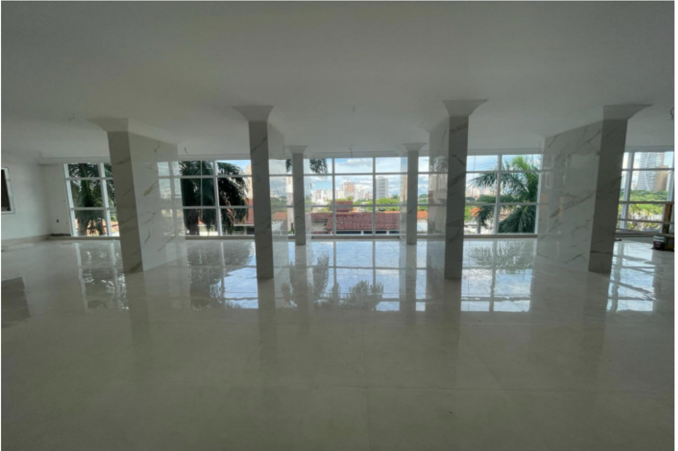
Figura 10 – Finalização do assentamento de porcelanato nos pilares do salão de festas – pavimento Lazer.
